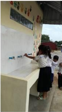
Lavabo de l'eau potable
