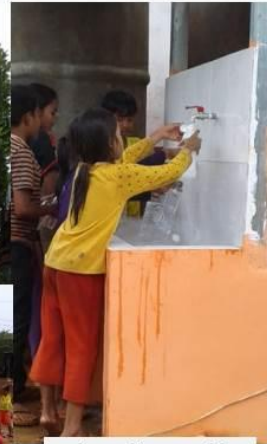
Robinet d'eau potable
